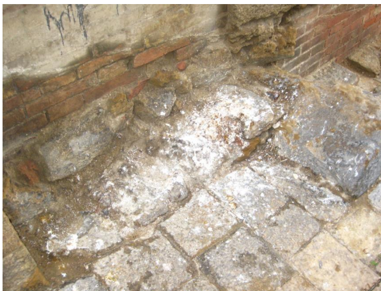
Foto 4 – Accumulo deiezioni di uccelli presso Porta all’Arco
