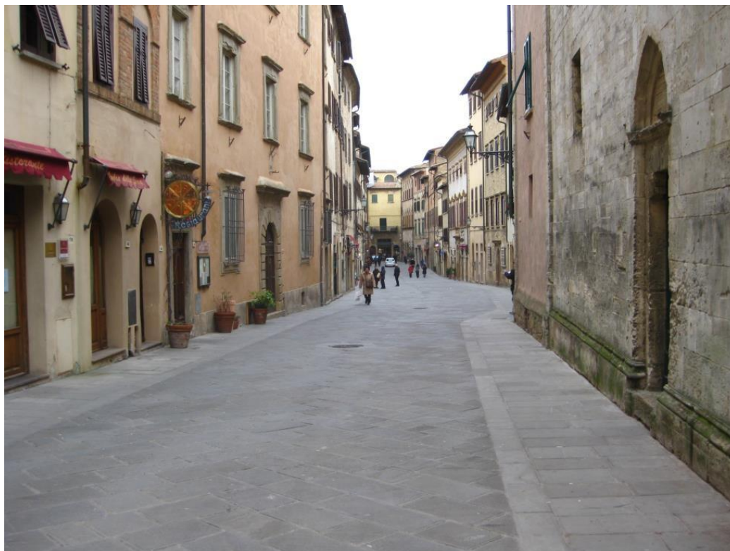
Foto 1 – Pavimentazione Via Gramsci
